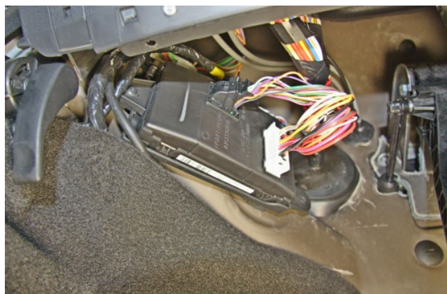
Фото 1.16. Защитная накладка снята
