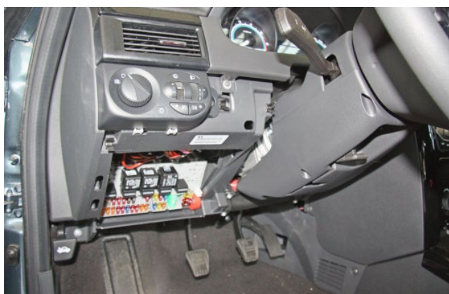
Фото 1.3. Пластиковая накладка снята
