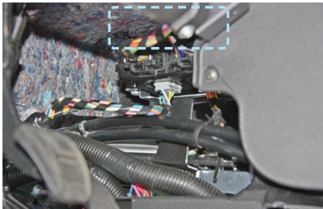
Фото 2.7. Пример расположения центрального блока охранно-телематического комплекса
